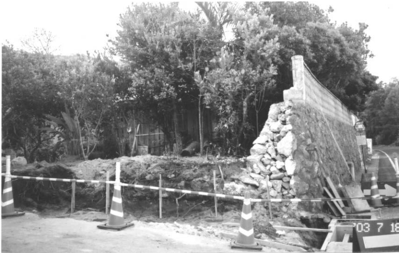
写真4 2003年7月18日 道路工事のため一時石垣をとりぞいた断面。II面をおおう砂丘の上に石垣2.0mを積み、さらに上方にブロック0.9mを積んだ石垣。循環道路に面した基井氏宅。
