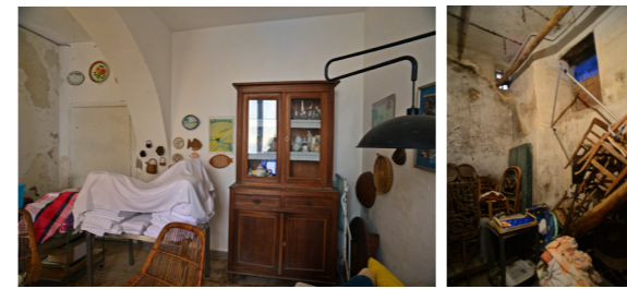
Porzione anticamente occupata dalla cisterna di cui rimane solo la canna di prelievo acqua da
