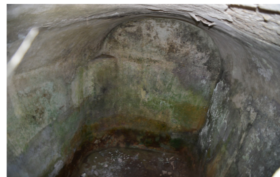
Cisterna non più funzionante sotto all'abitazione dell'arch. De Martino.
