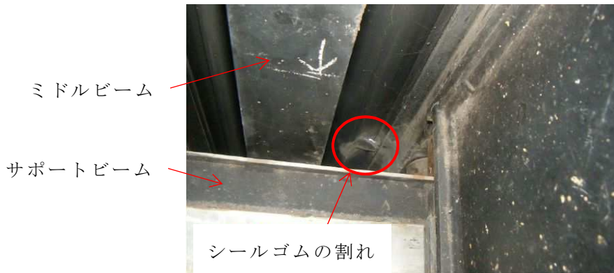
図 1-9 シールゴムの損傷例
