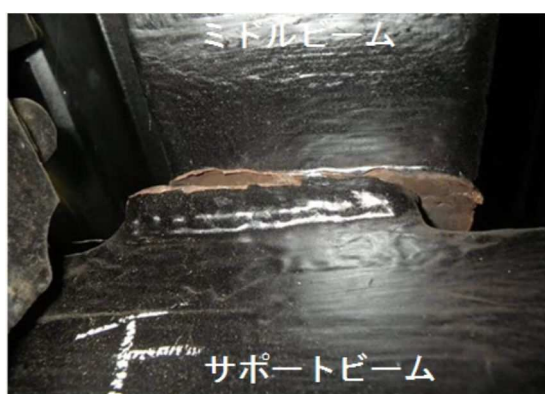
図 1-14 すみ肉溶接の疲労き裂[8]
