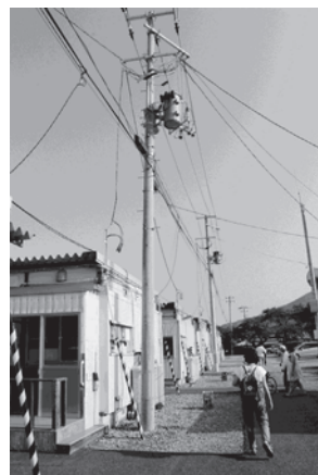
ソケットが落下した電柱
