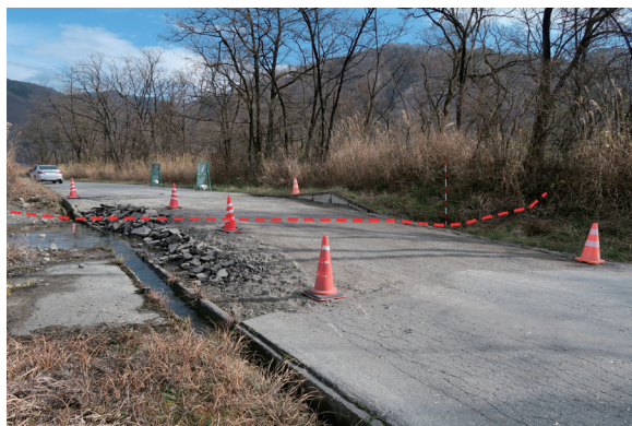
写真4 松川左岸堤道を斜めに横切って生じた変動崖（路面修復済み）（2014.11.24.撮影）
