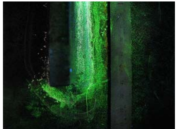
写真-2.120 垂直補剛材 北側西面き裂
