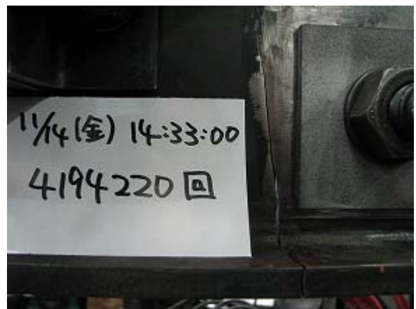
写真-2.30 A-1 試験体下フランジ破断状況
