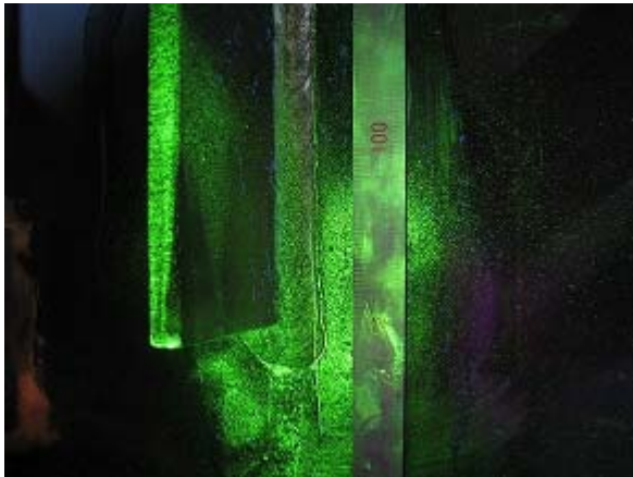
写真-2.111 垂直補剛材 南側西面き裂
