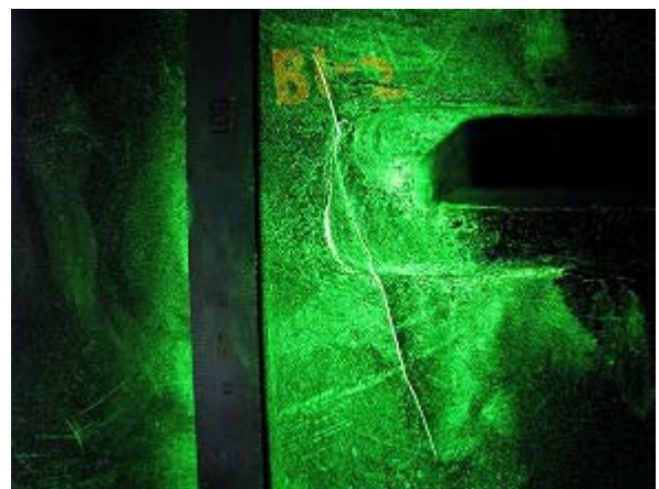
写真-2.36 WG1-S 補修前き裂 (東面)
