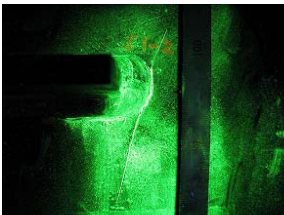
写真-2.35 WG1-S 補修前き裂 (西面)
