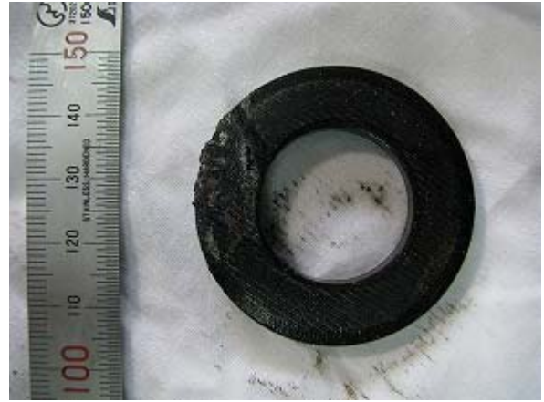
写真-2.140 垂直補剛材 南側西面ワッシャーき裂
