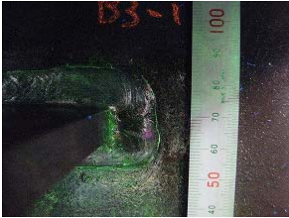
写真-2.25 WG3-N 初期き裂 (東面)
