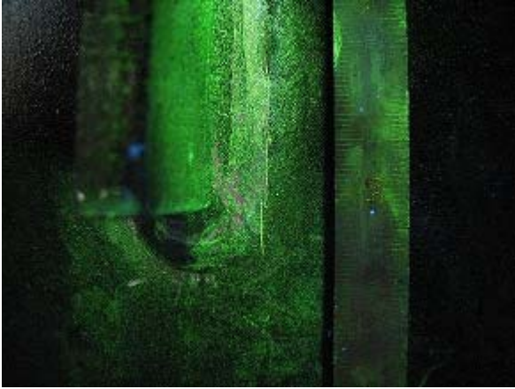
写真-2.121 垂直補剛材 南側西面き裂
