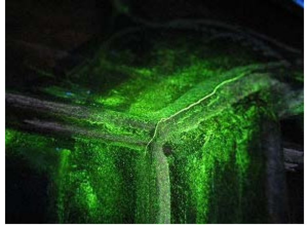
写真-2.158 載荷点 北側東面き裂状況(1)
