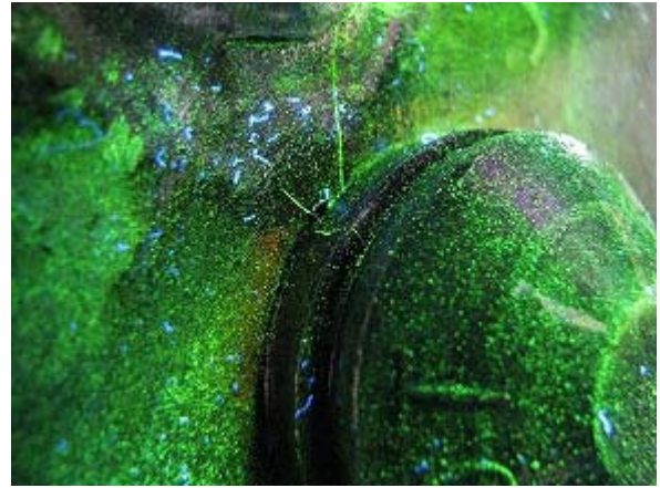
写真-2.128 垂直補剛材 北側ワッシャーき裂
