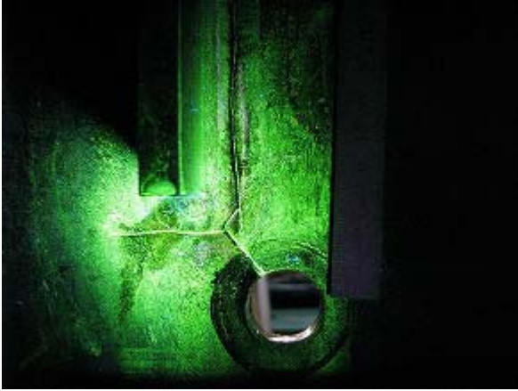
写真-2.133 垂直補剛材 南側西面試験終了後
