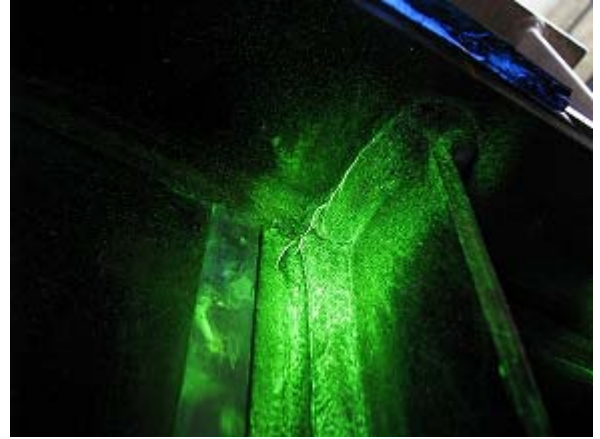
写真-2.146 載荷点 北側東面き裂状況(1)
