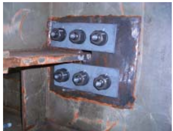
写真-1.6 添え板ボルト締めストップホール法
