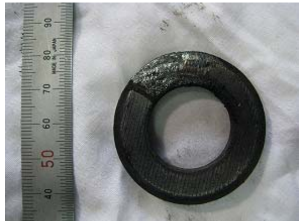
写真-2.138 垂直補剛材 北側西面ワッシャーき裂
