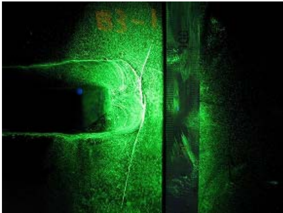
写真-2.27 WG3-N 補修前き裂 (東面)
