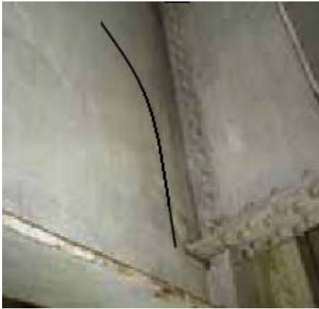
写真-1.1 山添橋の疲労き裂
