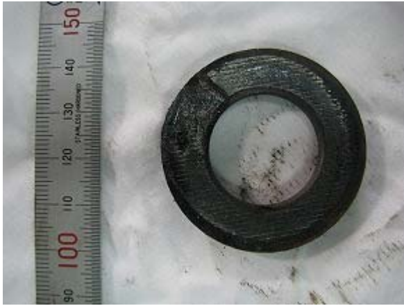
写真-2.139 垂直補剛材 北側東面ワッシャーき裂
