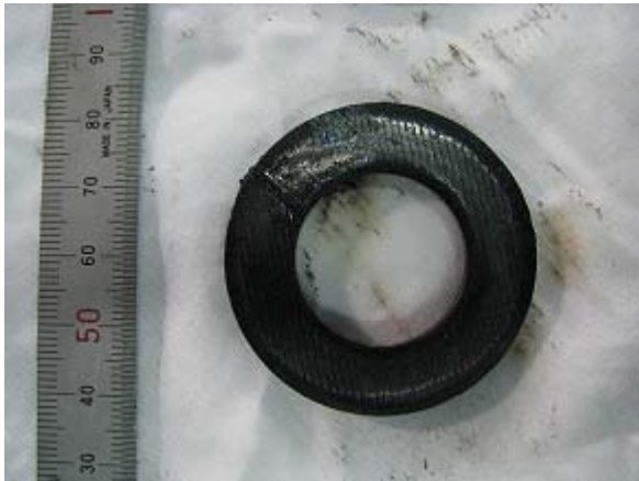
写真-2.141 垂直補剛材 南側東面ワッシャーき裂
